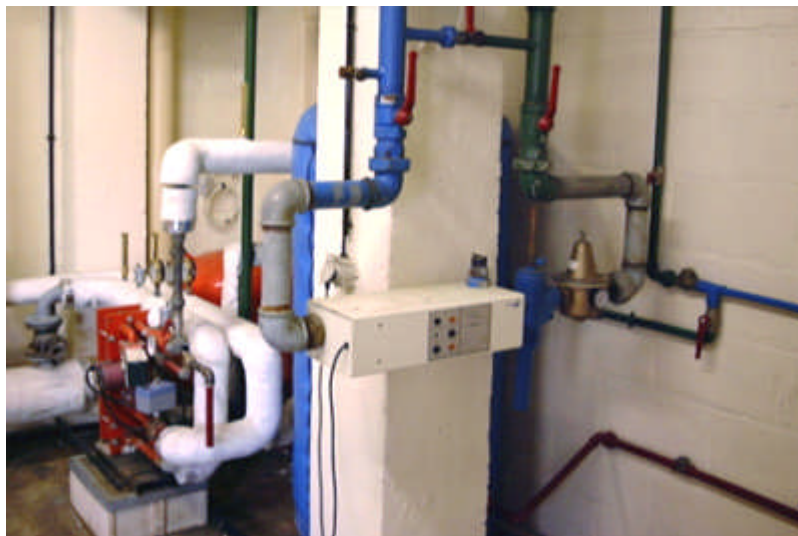
(ci-dessus : protection sur arrivée générale d'eau froide d'une production d'eau chaude sanitaire collective – immeuble de 60 appartements)
